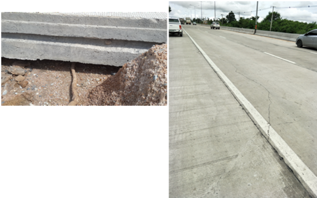
ภาพที่ 2 ผลจากการกัดเซาะของทรายรองถนนคอนกรีตออกจากคันทาง การกัดเซาะของทรายรองถนนคอนกรีตออกจากคันทางระหว่างการก่อสร้าง (ซ้าย) ความเสียหายจากการกัดเซาะของทรายรองถนนคอนกรีตระหว่างการก่อสร้าง (ขวา) (รูปจากถนน CRCP โครงการก่อสร้างทางหลวงหมายเลข 331 บ.เนินผาสุข-มาบเอียง ตอน 1)
